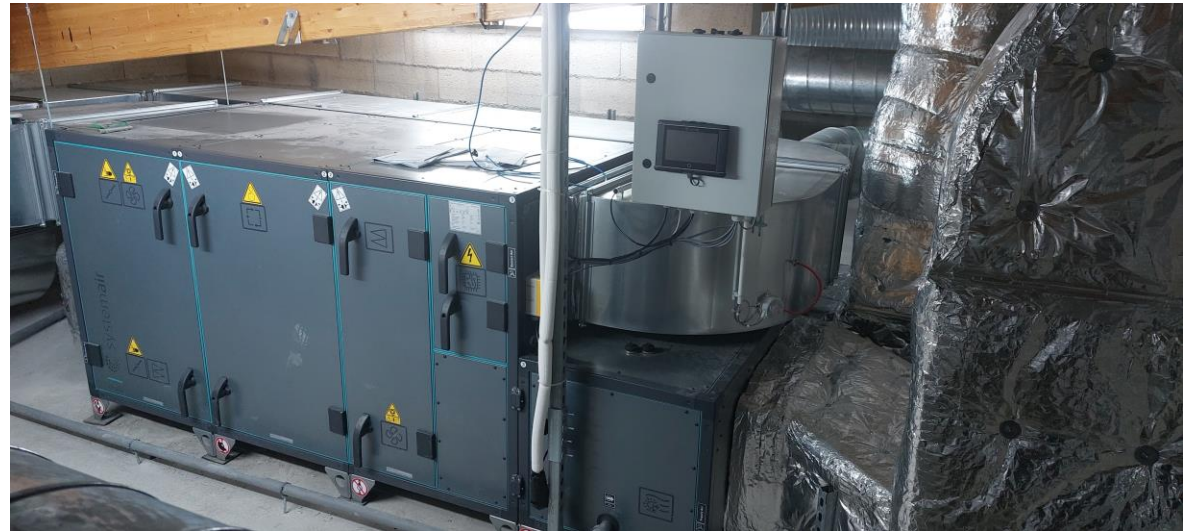
Centrale de Traitement d'Air (CTA) double-flux avec récupération de chaleur/fraicheur – EHPAD Maison Blanche à Beaucourt (90)
