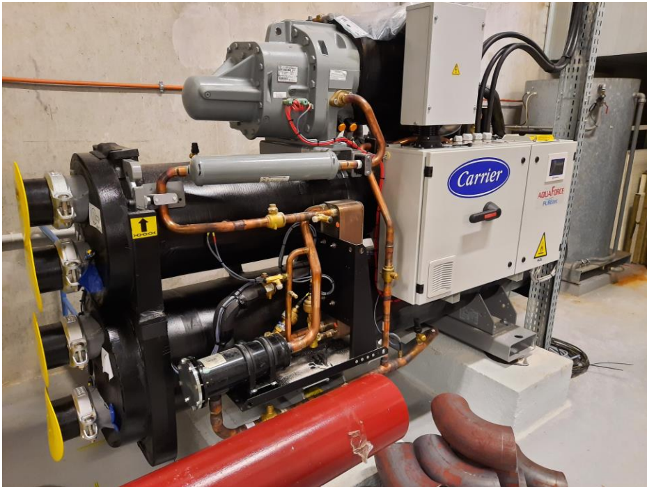
Système de récupération de chaleur sur les groupes froids – CH William Morey Chalon-sur-Saône (71)
