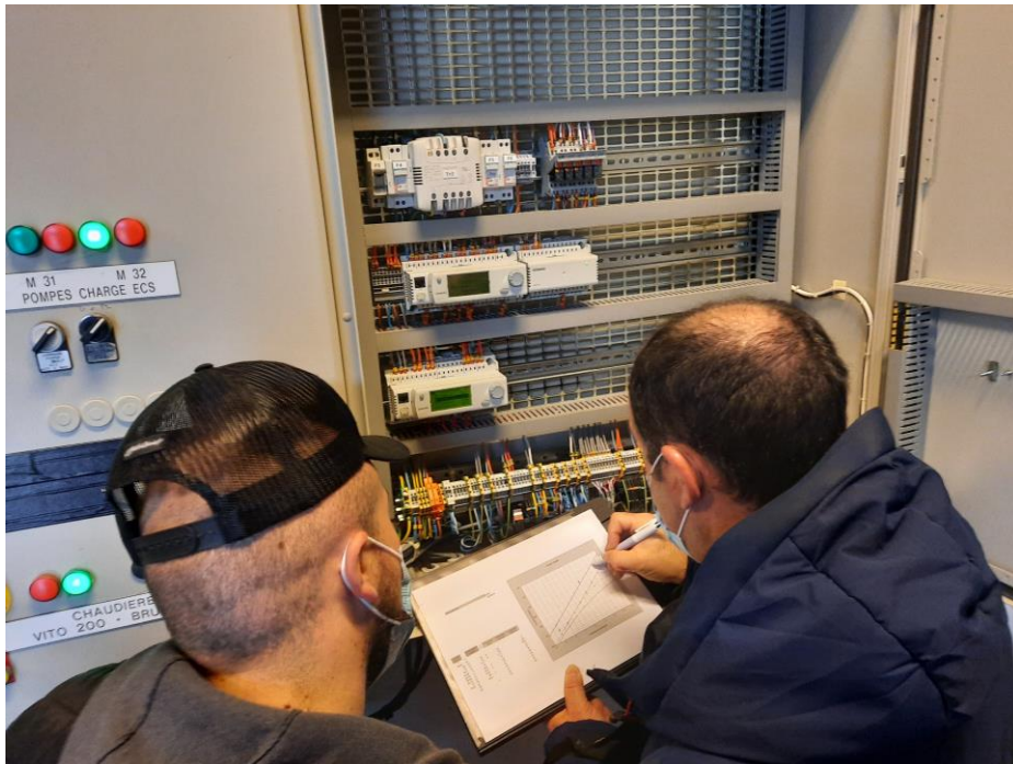
Réglage des températures (lois d'eau) – Les Eparses à Chaux (90)
