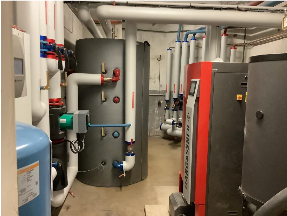
Nouvelle chaufferie granulés bois installée à l'ESAT Prestige Jura à Saint-Claude (39). Réception faite en mai 2023.
